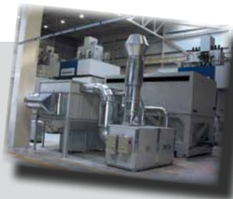
Sistema di aspirazione.
